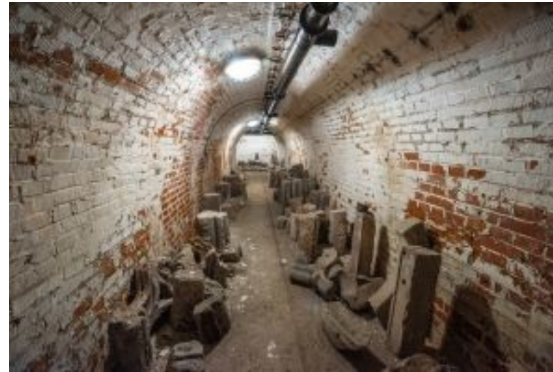
kryt Denis Brno – pod Petrovem celková délka dosahuje i s únikovými štolami zhruba 900 metrů
