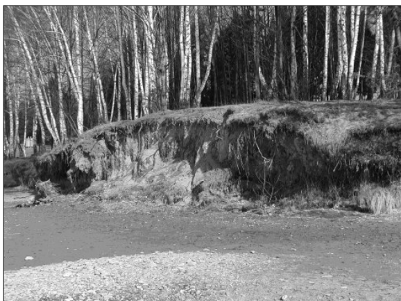
Obr. 12a: Abrázní sruby na Brněnské přehradě v lokalitě Sokolské koupaliště – rok 2003 (zdroj: Povodí Moravy, s. p.).
