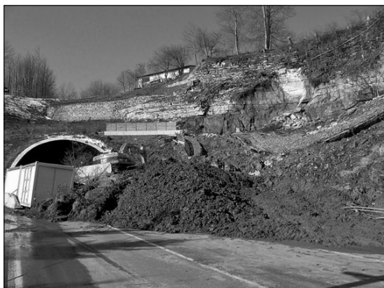
Obr. 4a: Sesuv u silničního tunelu Hřebeč (foto: I. Smolová).
