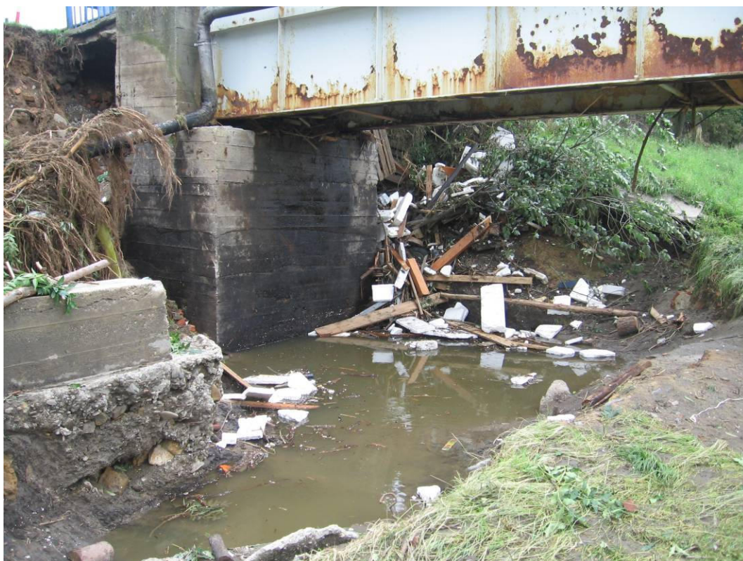
Foto 3.8 – Nátrž v okolí pravé břehové opěry lávky pro pěší přes Jičínku v Novém Jičíně
