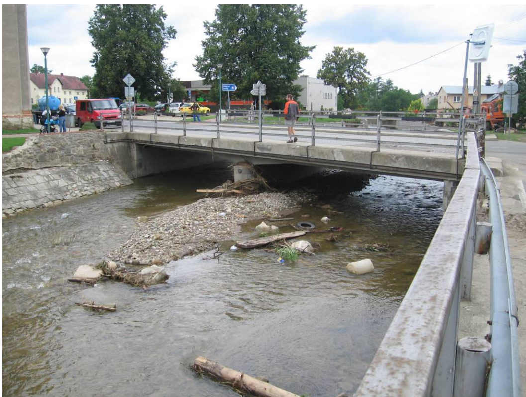
Foto 4.10 – Částečně zanesený profil silničního mostu v Bernarticích na Vojtovicém potoce
