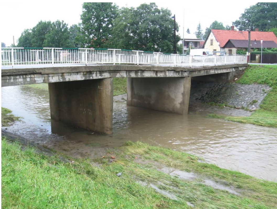
Foto 3.12 - Podemletý pilíř jednoho z mostních objektů přes Jičínku v Kuníně
