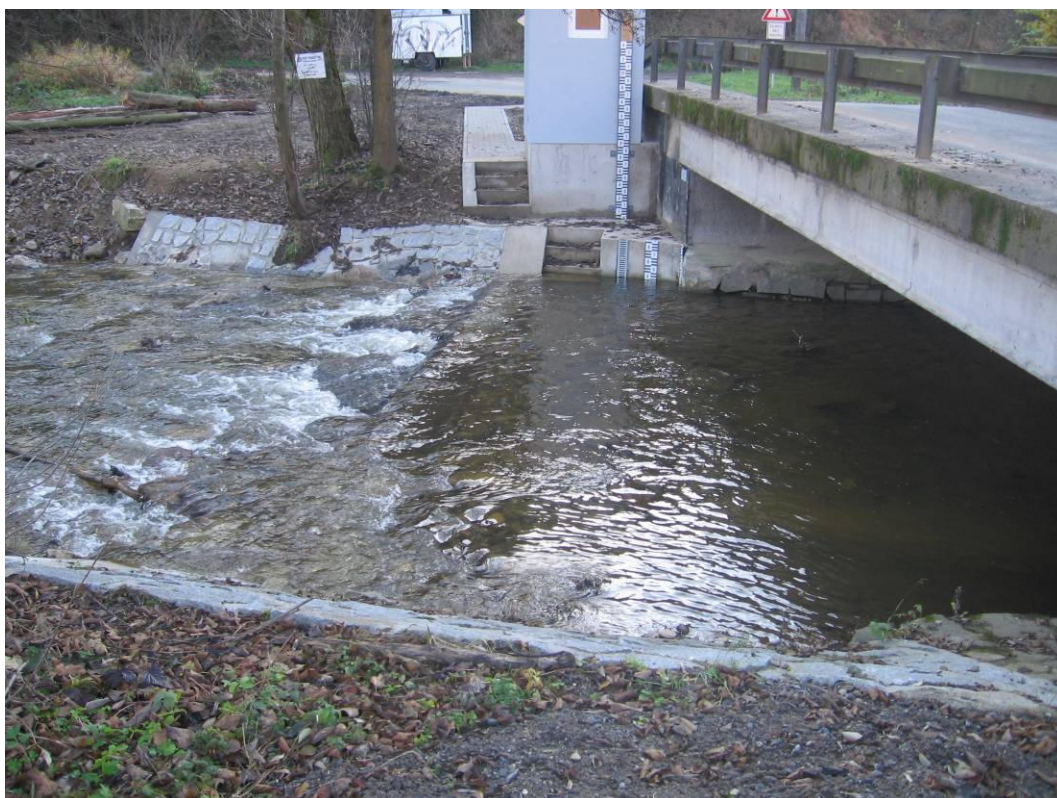
Obr. 6.3 – Objekt limnigrafické stanice Sudslavice na Volyňce se stabilizačním prahem.
