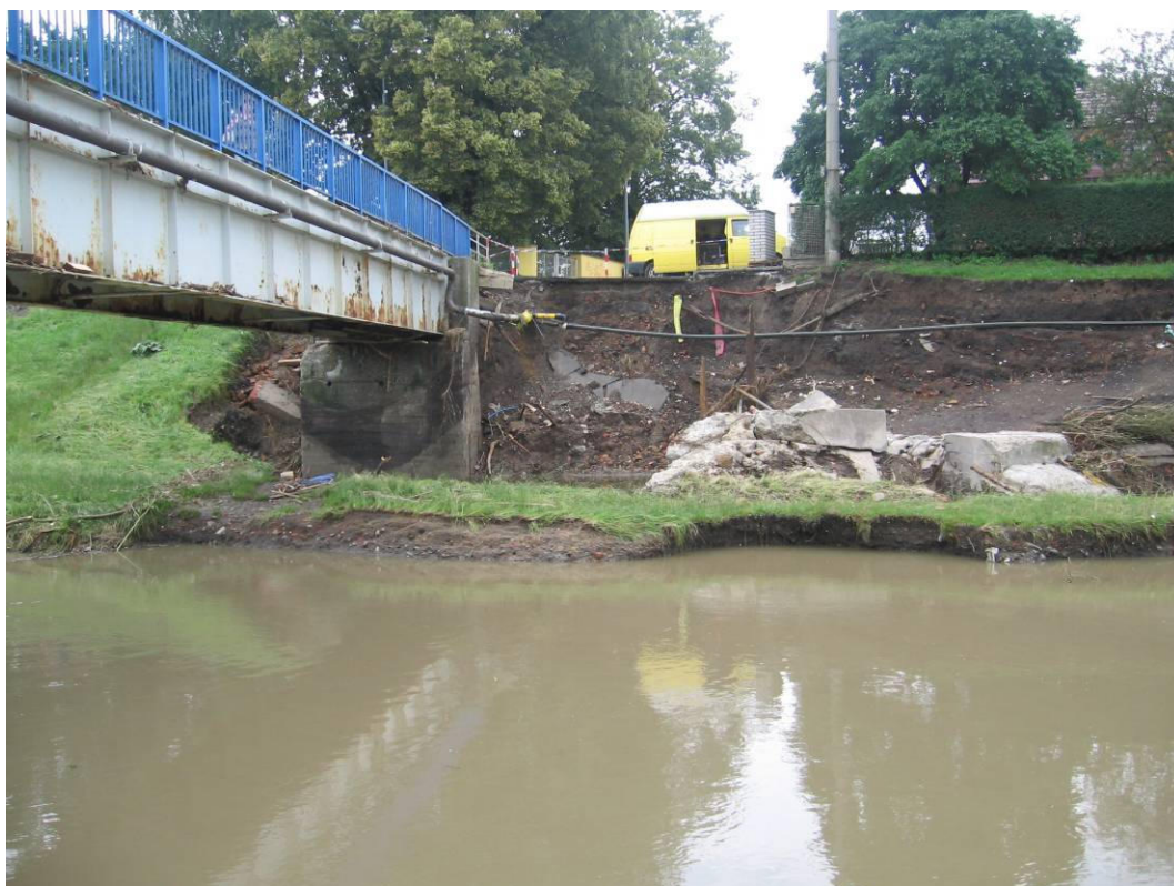
Foto 3.9 – Nátrž v okolí levé břehové opěry lávky pro pěší přes Jičínku v Novém Jičíně
