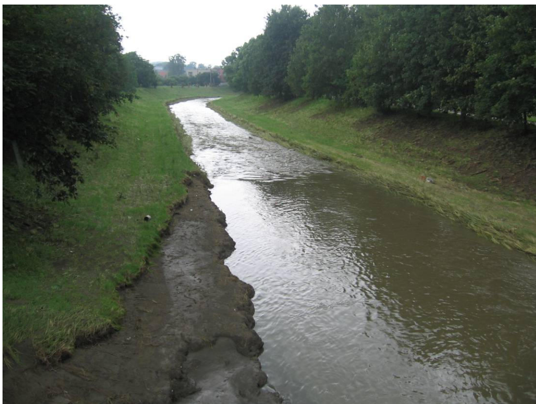
Foto 3.10 – Drobné poškození travního opevnění pod jedním z mostů na Jičínce v Kuníně
