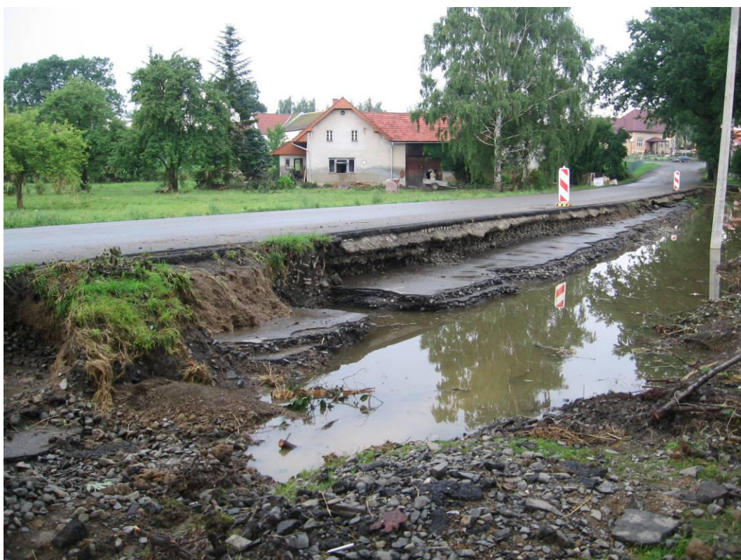
Foto 3.17 – Eroze náspu silnice vedoucí napříč inundací vlivem přelévání vody
