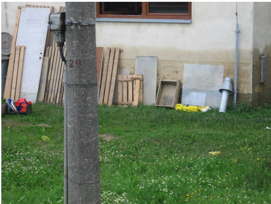
Foto 3.15 – Typická stopa po kulminační hladině na jedné ze staveb včetně navlhle omítky do vyšší úrovně vlivem následného vzlínání vody
