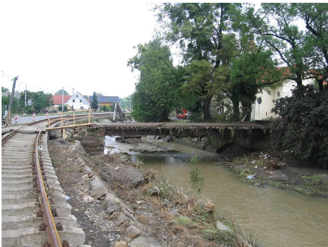
Foto 3.3 – Poničený cestní most přes Zrzávku v Bludovicích
