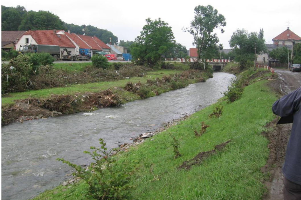
Foto 3.1 – Stav koryta Jičínky v Žilině v posuzovaném úseku.
