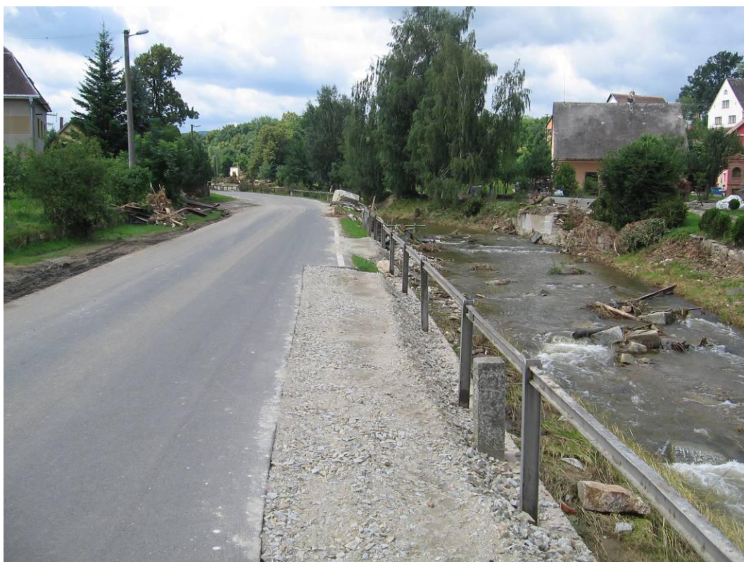
Foto 4.8 – Horní část měrné tratě v Bernarticích s profilem zničeného mostu
