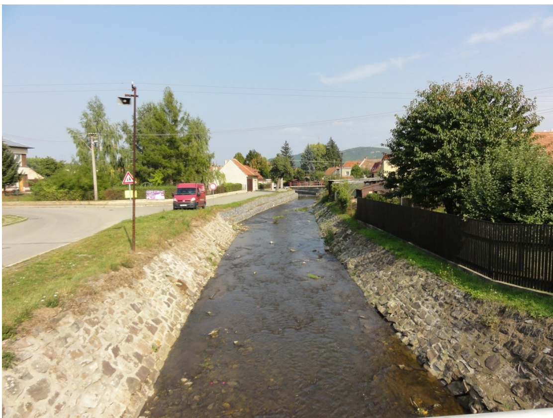
Foto. 8. Technicko-inženýrská úprava na toku v podobě kamenobetonového lichoběžníkové profilu koryta ve Veverské Bítýšce
