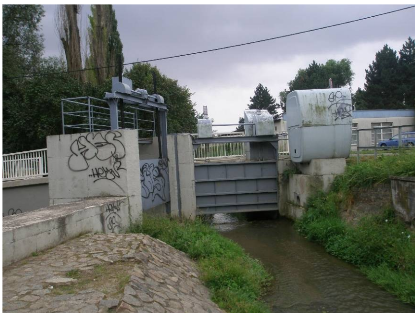
Obr. 22: Retenční nádrž v Řečkovících.
