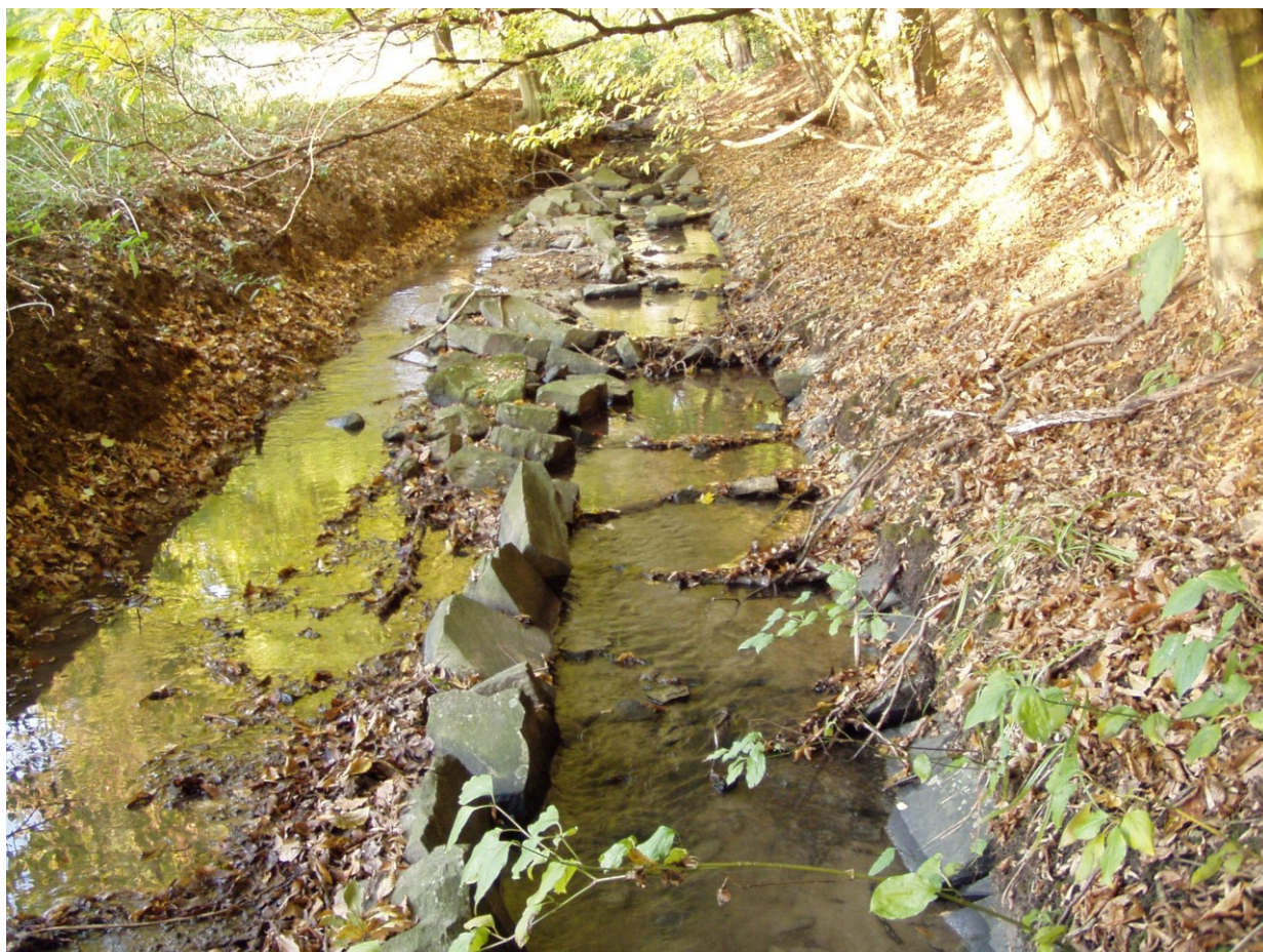
Foto 4: Rozrušené opevnění napřímeného úseku pod Spálenou skálou
