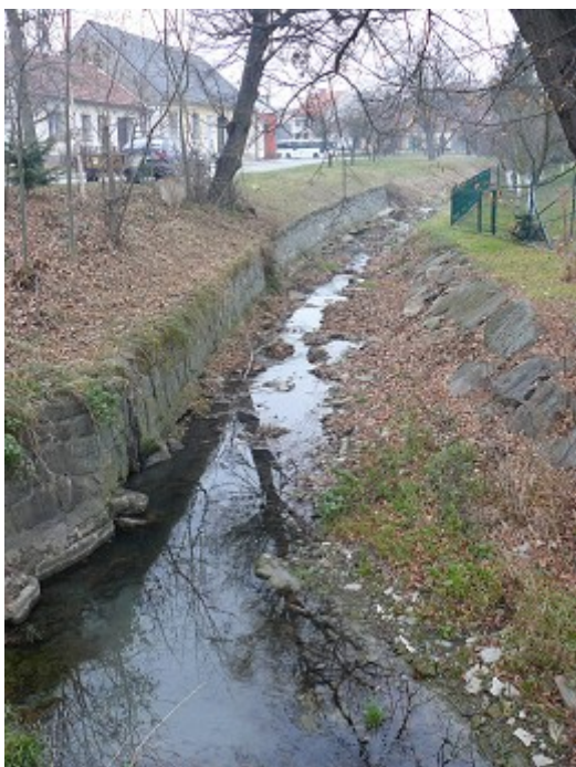
Obr. 11. Opevnění koryta kamennými bloky a stěnou po obou stranách břehu v Horním Němčí
