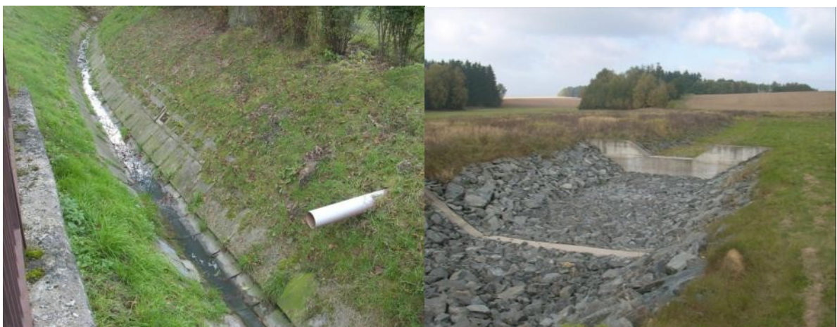
Obr. 12, 13 Opevnění dna betonovými skružkami a břehová zatravnovací dlažba; Kamenný zához v korytě přepadu jednoho z poldrů
