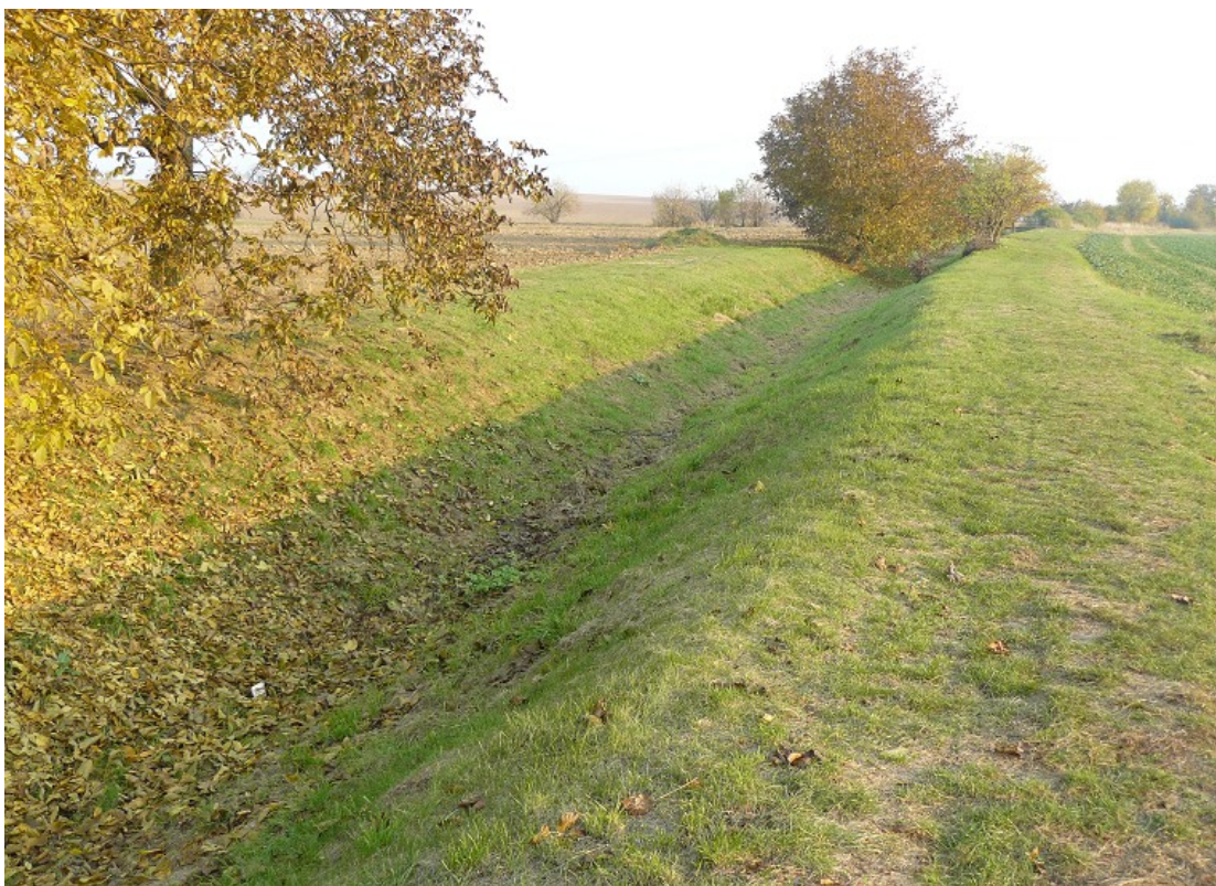
Obr. 32: Místo ztráty vody v korytě – pohled po proudu
