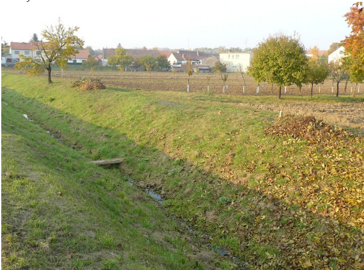
Obr. 31: Místo ztráty vody v korytě – pohled proti proudu, v pozadí Mělčany
