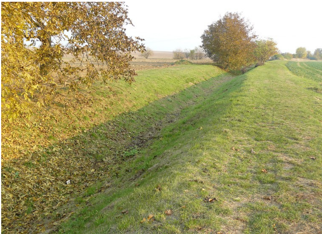
Obr. 31: Místo ztráty vody v korytě – pohled po proudu
