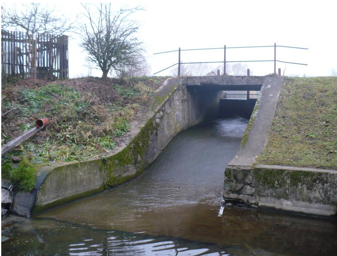
Foto 15 Skluz při ústí Horního rybníka v Pokojovicích (T. Bumba 2011)
