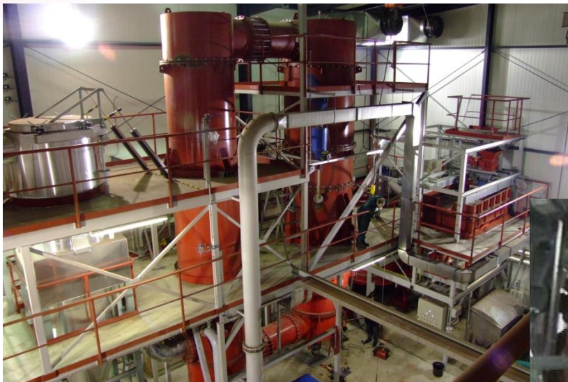
Fluidní spalovací pec
