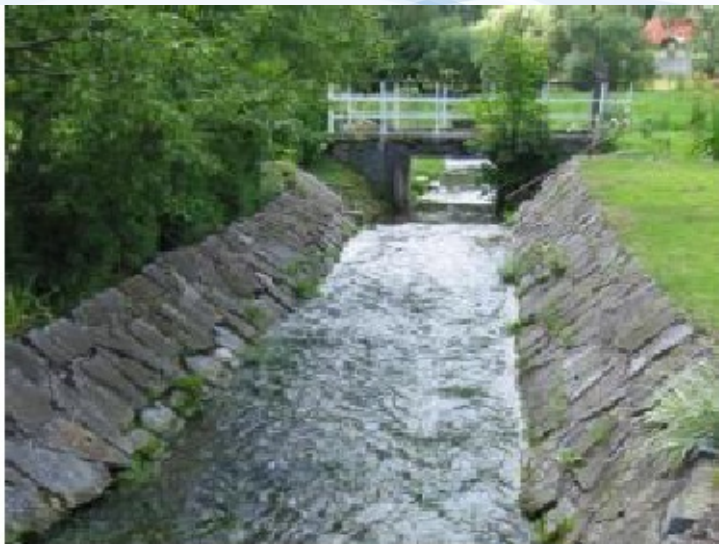
Souvislá úprava dna i břehů kamennou dlažbou
