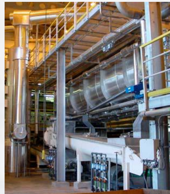
Sušení kalu ČOV Brno - Modřice
