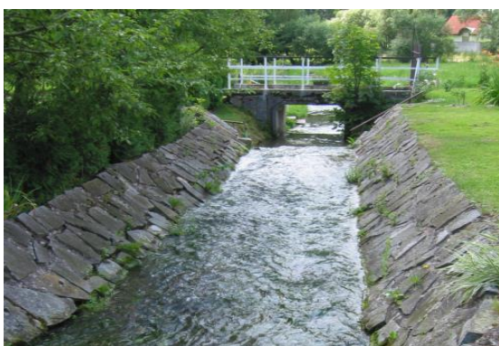
Souvislá úprava dna i břehů kamennou dlažbou
