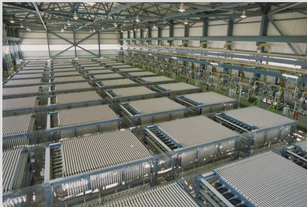
Hala s membránovými elektrolyzéry
